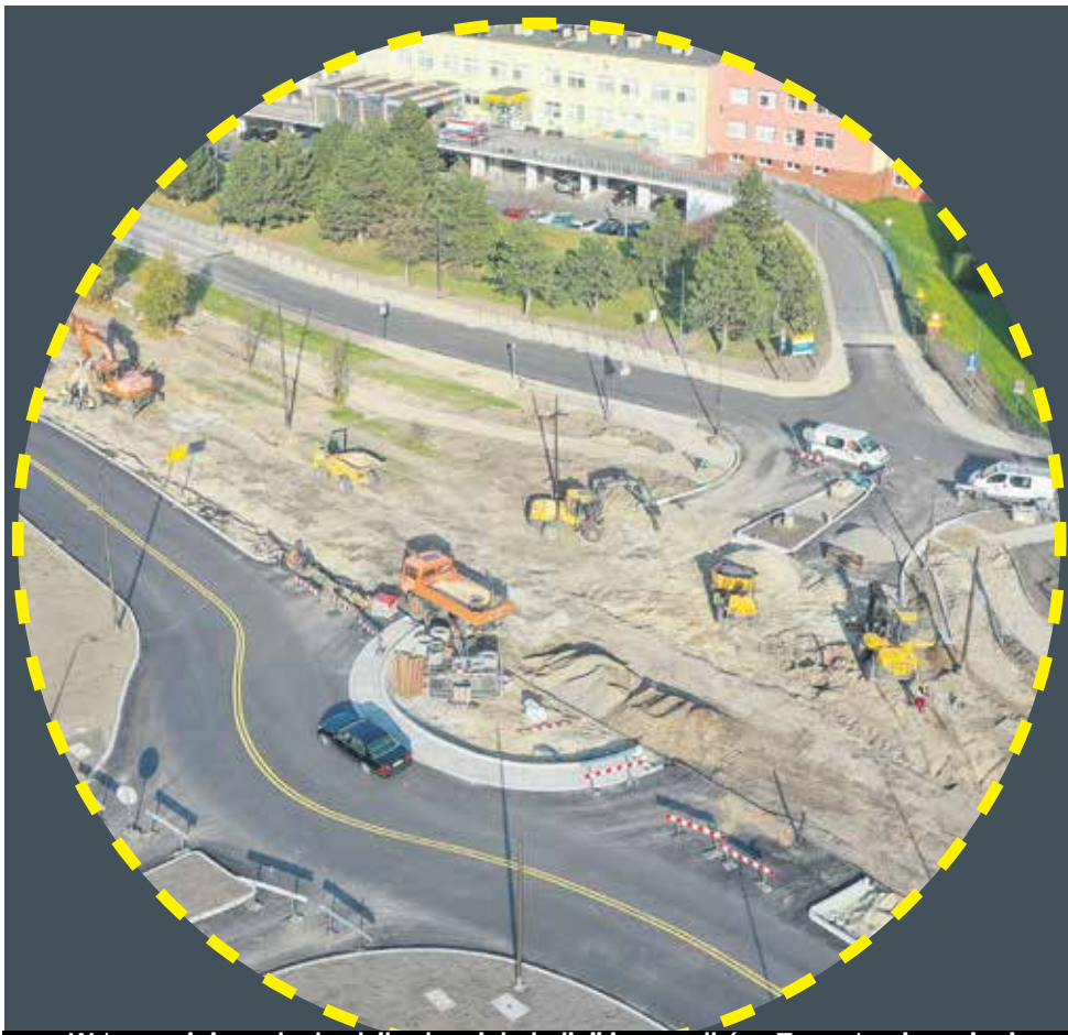
W tym miejscu dochodziło do wielu kolizji i wypadków. Teraz to się zmieni.
